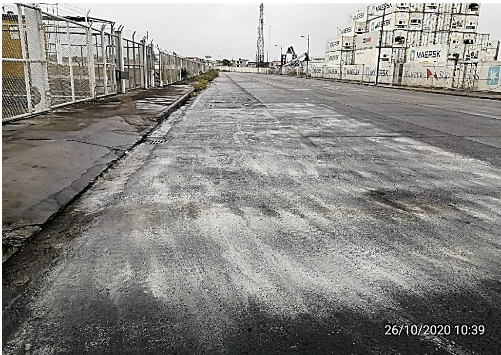
Acceso frontal a Zona de Combustibles
