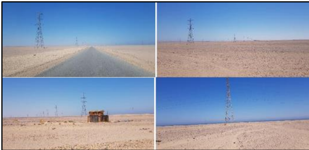
شكل رقم 5-17 أبراج الكهرباء الموجودة بالمنطقة المحيطة بالمشروع
